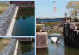
水位が同じになったら水門が開けられ、船が出て行く。閘門内（閘室）の側壁を見ると、水位が下がったことがわかる
